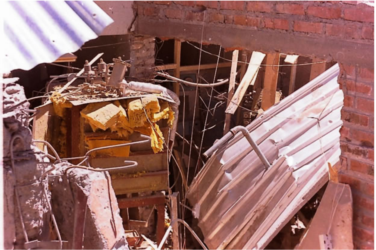
Sala de máquinas vista desde la calle Lamadrid
