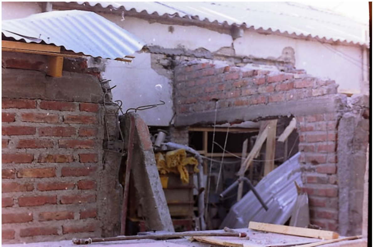
Otra toma de la Sala de Máquinas - Falta todo el techo
